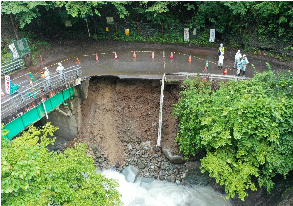
令和3年8月16日護岸崩落箇所被災状況(厚木土木-1)
